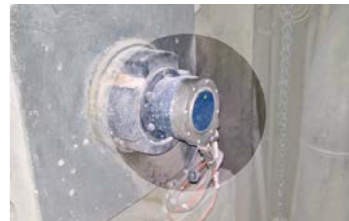
Produktionsmiljön är tuff mot motorer och komponenter, men en grön LED på pulsgivaren visar att allt fungerar som det ska.
